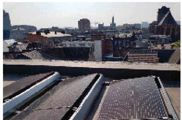
Photovoltaikpanels auf dem Dach verbessern die Energiebilanz des Gebäudes. (Foto: ARGE SOLAR)
