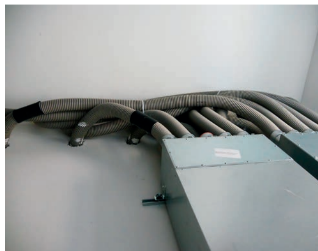
Vue de la technologie (Photos : ARGE SOLAR)
