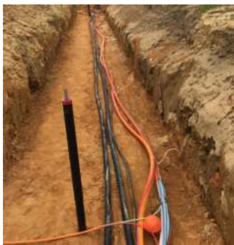
Obere Verlegeebene mit Steuerkabel, Telekommunikation, Stromversorgung, Beleuchtung © GWBS
